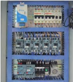
Caja eléctrica · Fuente de alimentación de 24 V. · Todos los contactores y relés SIEMENS o Schneider.
